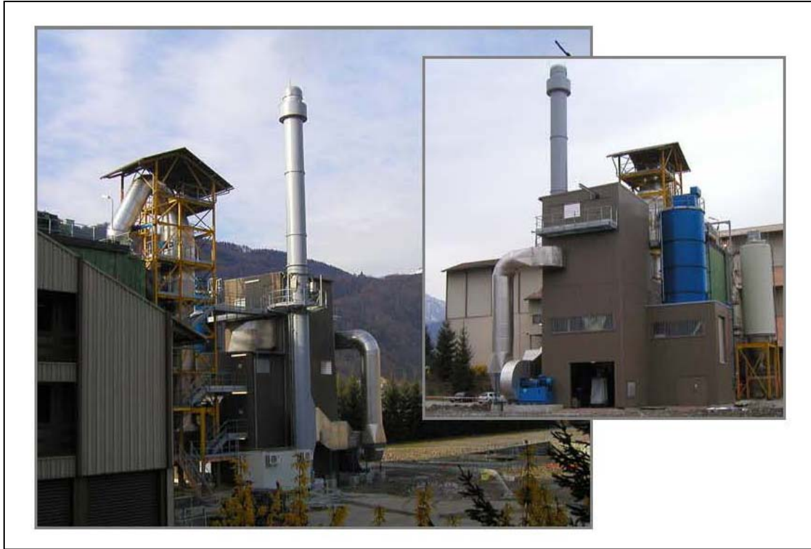
Abb. 1: MVA Cluses/ Frankreich
